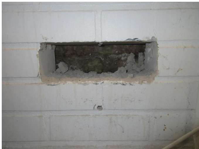
Kuva 2. Eristevilla seinän sisällä oli tummunutta.
