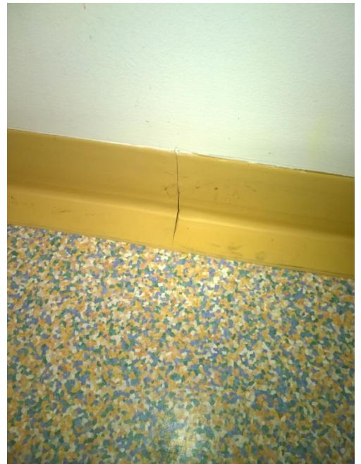
Kuva 10. Jalkalistan liitos epätiivis
