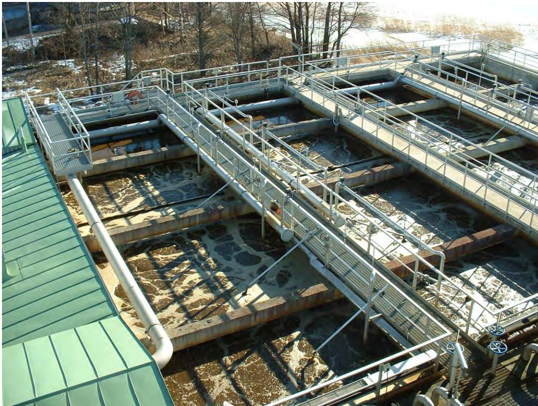
Skeppsholmens reningsverk luftningsbassänger
