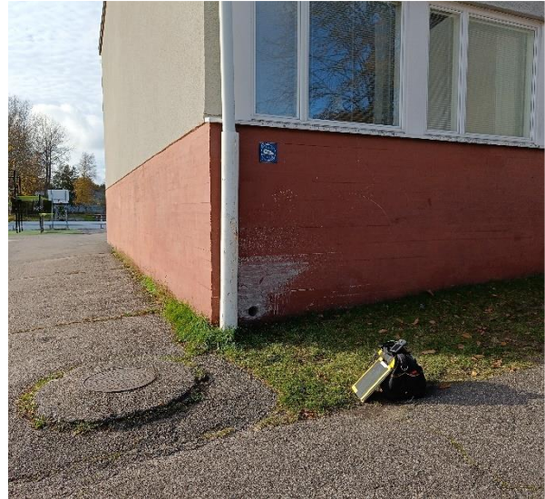
Kuva 8 Osa sadevesisyöksyistä on liitetty suoraan sadevesijärjestelmään.
