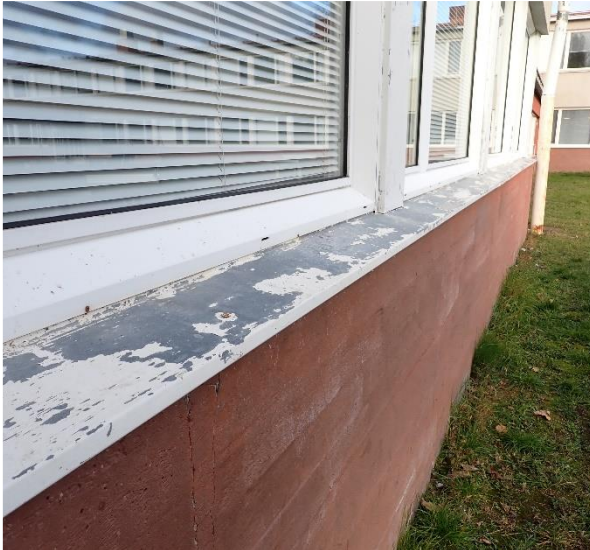
Kuva 72 Rakennuksen ikkunoita on uusittu muovikarmi-ikkunoiksi. Ikkunapellitysten kallistusten havaittiin olevan puutteellisia. Pellitysten maalipinta on kulunut.
