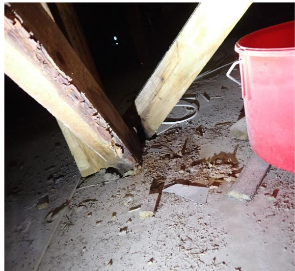
Kuva 103 Vuotojälkiä yläpohjatilassa A-osalla.
