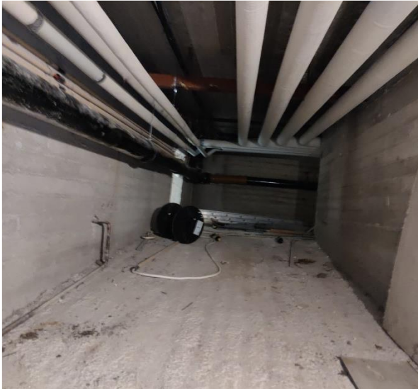
Kuva 35 Kellarikerroksessa sijaitseva tekniikkatunneli.
