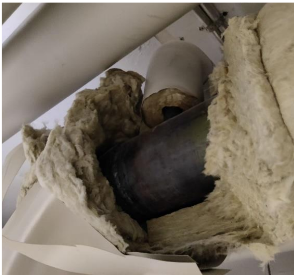
Kuva 114 Kaukolämpöpaketin rikkoutunut villaaeriste.
