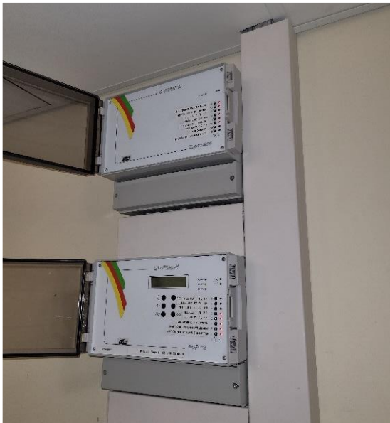
Kuva 165 Keskukset QW-TIME III, toimii myös mm. valaistuksen ohjauksessa.
