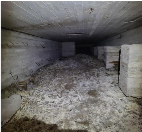
Kuva 41 Liikuntasalin alapohjarakenteena on ylälaattapalkisto. Alapohjan alustilaa tuuletetaan koneellisesti. Tuulettavuus ei ole havaintojen perusteella riittävää koko alapohjatilan osalta. Täyttöainne on tilassa hienojakoista.
