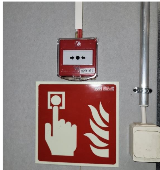
Kuva 174 Palopainike ilmanvaihdon konehuoneessa.
