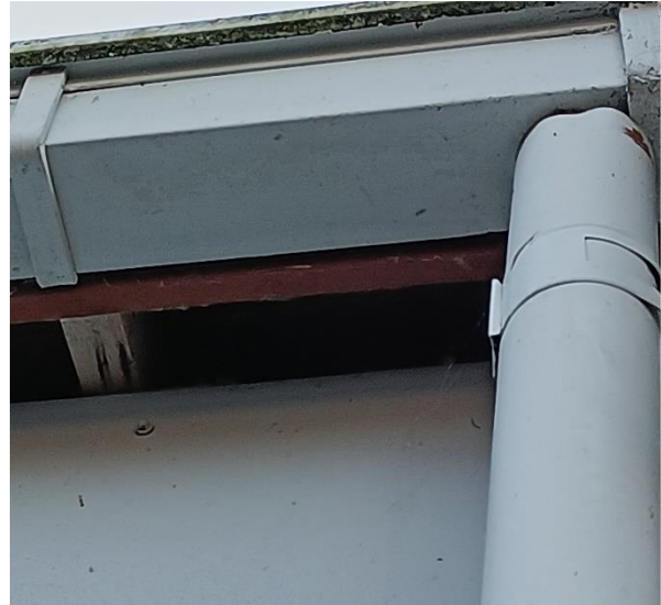
Kuva 97 Sisäänkäyntiaulan räystäs rakenteissa ei ole vastapellityksiä, jolloin vettä ja lunta voi kulkeutua tuulen mukana yläpohjatilaan.
