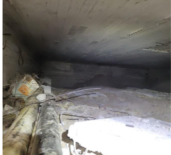
Kuva 40 A-osan päädyn alla oleva alapohjatila. Tilassa on jonkun verran rakennusjätettä.
