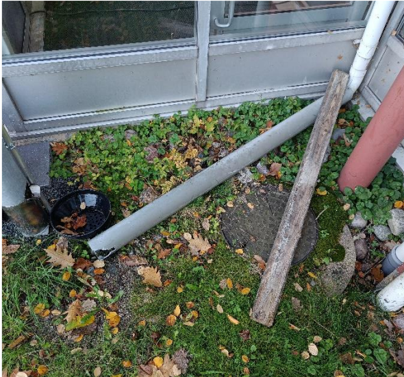
Kuva 11 Sadesi on ohjattu rakennuksen vierustalle pääsisäänkäynnin katokselta pohjoissivustalla.
