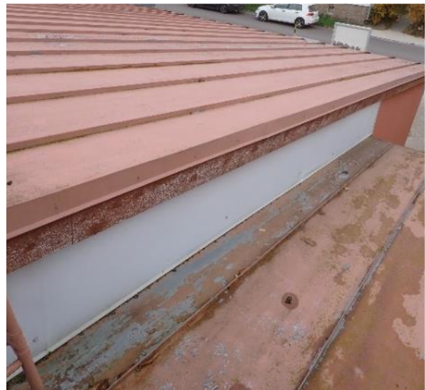
Kuva 87 Vesikatteessa on paikallisia ruostevaurioita ja maalipinnan hilseilyä.
