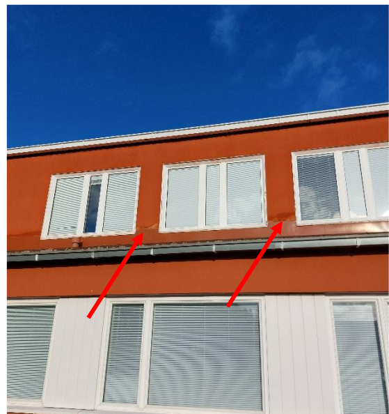
Kuva 64. Laajennusosan julkisivut ovat levyrakenteisia. Ikkunoiden välissä havaittiin vauriojälkiä julkisivussa vesikaton peltiylösnoston yläpuolella.
