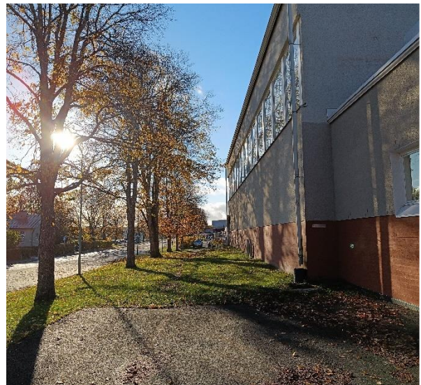
Kuva 6 Kuva liikuntasalin kohdalta. Maanpinta on tasainen / kallistaa hieman rakennusta kohti. Liikuntasalin perustus- ja alapohjarakenteisiin kohdistuu ryömintätilasta tehtyjen havaintojen perusteella kosteusrasitusta.
