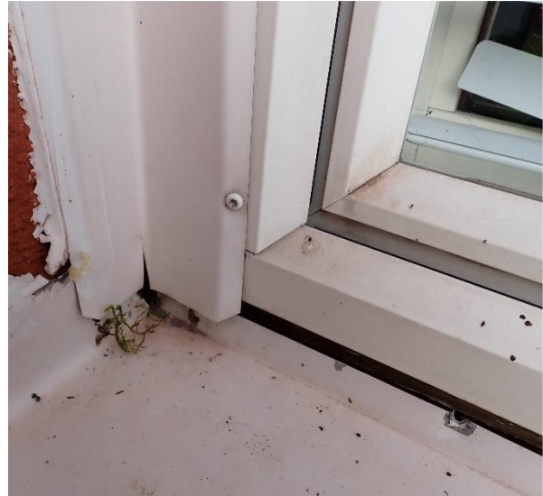
Kuva 73 Ikkunan pellityksissä havaittiin epätiiveyttä.
