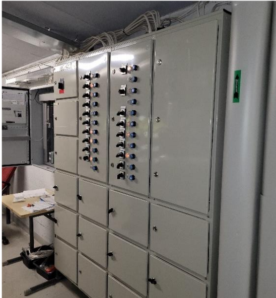
Kuva 137 Ilmanvaihdon ryhmäkeskus konehuoneessa.
