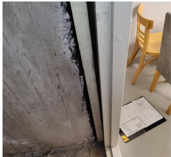
Kuva 29 Osa sisäpuolelta lämmöneristetyistä tiiliverhoilluista seinistä on uusittu. Uudet seinärakenteet on eristetty XPS-eristeellä ja sisäpuoli on verhoiltu kipsilevyllä. Kuva on kellarissa sijaitsevasta taukotilasta.
