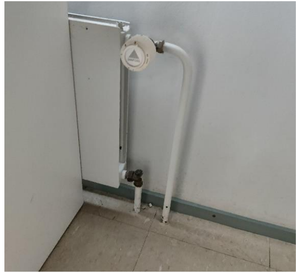
Kuva 116 Lämmityspatterille johtava lämpöjohto.
