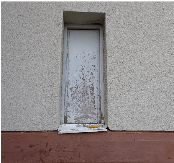
Kuva 74 Liikuntasalin puinen luukku, joka on heikkokuntoinen.
