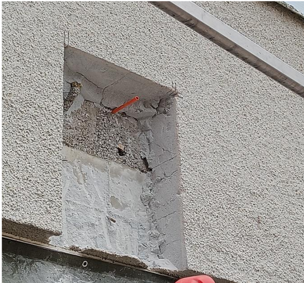
Kuva 69 Alkuperäisen osan kevytbetonisen ulkokuoren kuntoa ja kiinnittyvyyttä tarkasteltiin rakenteeseen tehdyn avauksen kautta.
