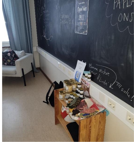
Kuva 140 Pistorasioita opettajainhuoneen johtokanavassa.
