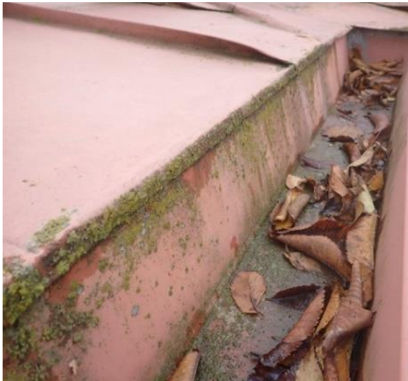
Kuva 88 Räystäskouruissa on sammalkasvustoa ja lehtiä.
