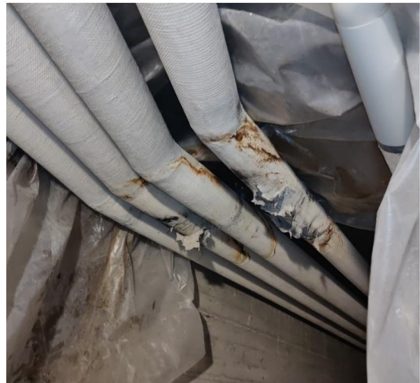
Kuva 38 Tekniikkatunnelissa todettiin olevan rikkoutuneita asbestiputkieristeitä.
