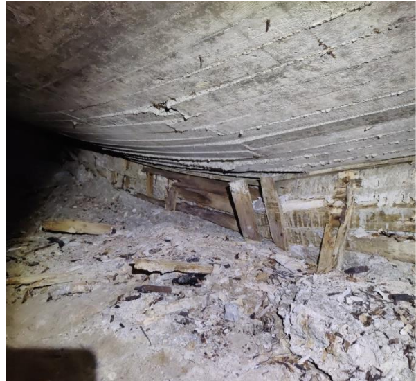
Kuva 44 Liikuntasalin alapohjarakenteessa on jonkun verran vaurioituneita muottilauδοituksia.
