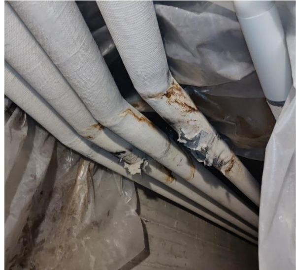
Kuva 36 Tekniikkatunnelissa todettiin olevan rikkoutuneita asbestiputkieristeitä.
