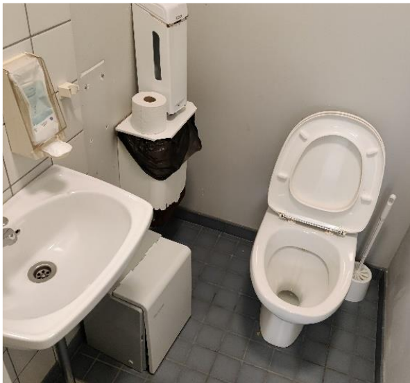
Kuva 125 Yleiskuva wc:n vesikalusteista.
