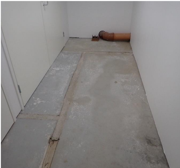
Kuva 49 Talojakamon edustalla havaittiin alapohjarakenteen valussa sijaitsevia puurakenteita.
