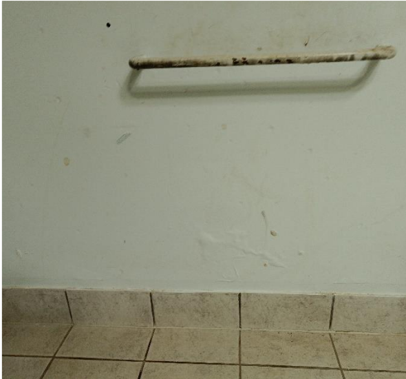
Kuva 30 Kellarikerroksessa sijaitsevan alapohjatunnelin tarkastusluukun kohdalla olevan maanvastaisen seinärakenteen alaosassa todettiin kohonnutta kosteutta ja vauriojälkiä maali- ja tasotepinnassa.
