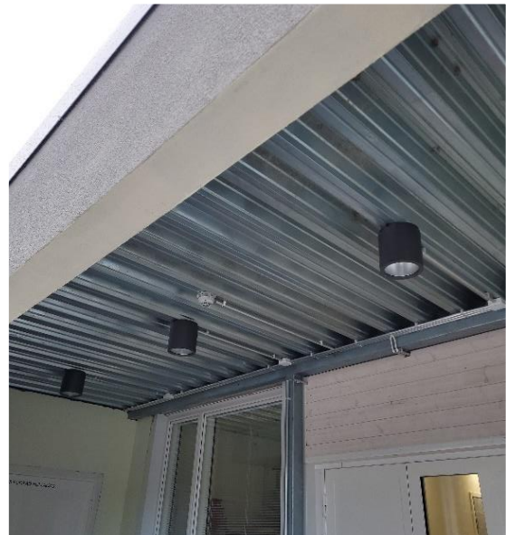
Kuva 154 Katoksen 2020-luvun valaisimia.
