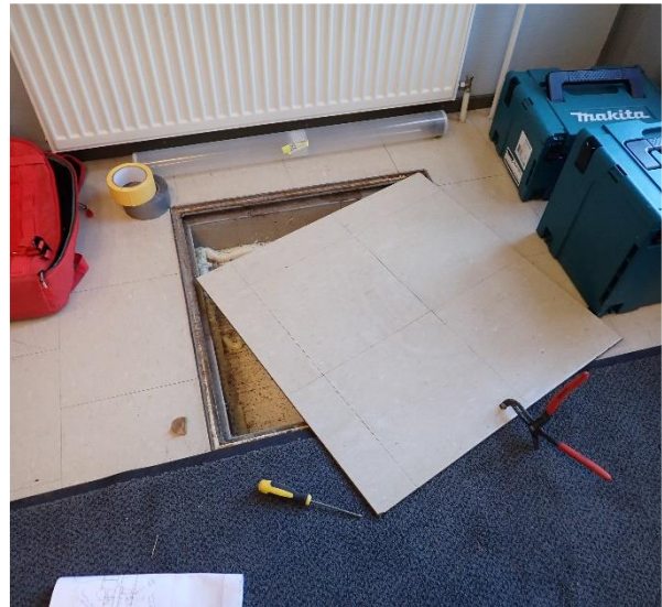
Kuva 50 Kuva C-osan laajennuksen alapohjan tarkastusluukusta. Alapohjatilassa havaittiin kosteutta.
