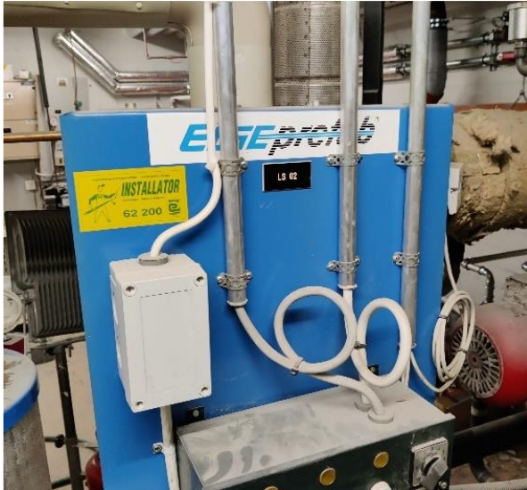
Kuva 112 Kaukolämpöpaketin kiertovesipumppujen ohjaus.
