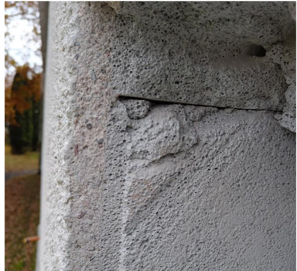
Kuva 70 Kevytbetoniharkkojen pinnassa on rappauserros.
