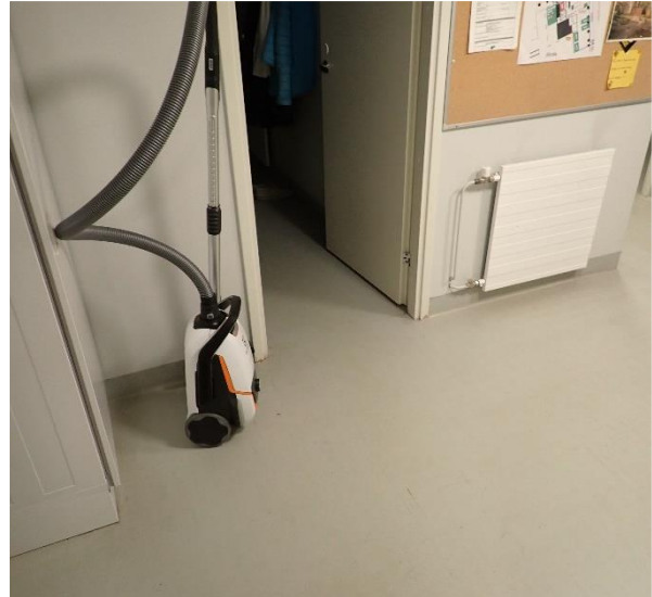
Kuva 48 Alapohjarakenteet on päällystetty kellarikerroksessa osittain vesihöyryä heikosti läpäisevillä muovimatoilla. Mattojen alla todettiin paikoittain kohonnutta kosteutta.
