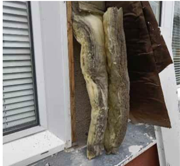
Kuva 80 B-osalla avattiin takapihalla sijaitseva nauhaikkunalinjan kotelorakenne. Rakenteen tuulensuojapaperissa ja eristekerroksessa todettiin voimakasta tummumista. Ulkopuolinen pellitys ei ole sadevesitiivis. Rakenteen eristekerroksessa todettiin mikrobivaurioita.
