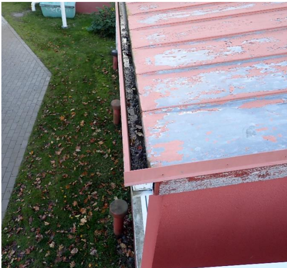
Kuva 94 Rästyslautojen maalipinta on hilseillyt. Sadevesikouruissa on roskaa.
