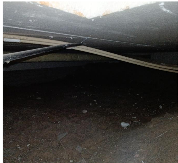
Kuva 46 Laajennusosan kohdalla alapohjarakenteena on alapuolelta lämmöneristetty rakenne. Alapohjatilalla on tuulettuva. Alapohjatilassa todettiin olevan runsaasti kosteutta. Täyttöaines on hienojakoista hiekkaa.
