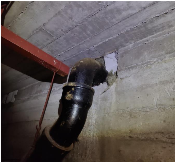
Kuva 37 Kellarikerroksessa sijaitseva tekniikkatunneli. Lämpivienti ylemmään kerrokseen on tiivistetty mineraalivillalla.
