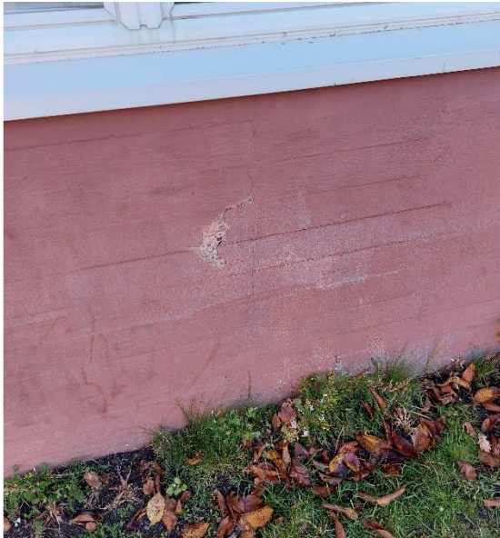
Kuva 24 Pystyhalkeama sokkelissa sekä betonin pintaosan irtaamista.
