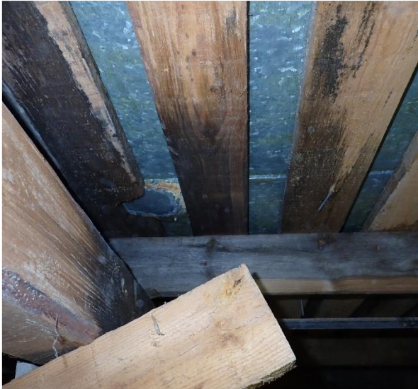
Kuva 104 Tummentumia vesikatteen aluslaudoissa. Peltikatteen alla ei ole aluskatetta.
