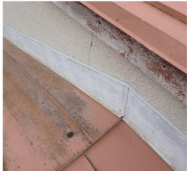
Kuva 95 Rästäslautoitusten maalipinnat irtoilleet.
