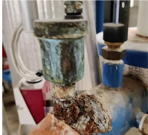
Kuva 113 Kaukolämpöpakettiin liitetty huonokuntoinen varoventtiili.
