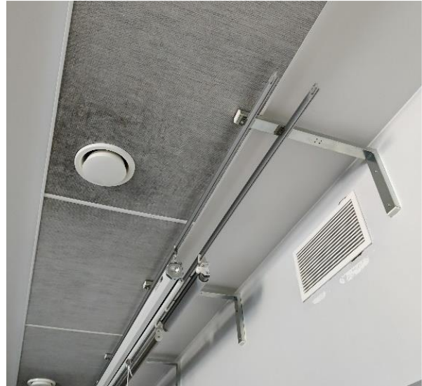
Kuva 132 Poistoilmaventtiili sijoitettu tuloilmaventtiin eteen.
