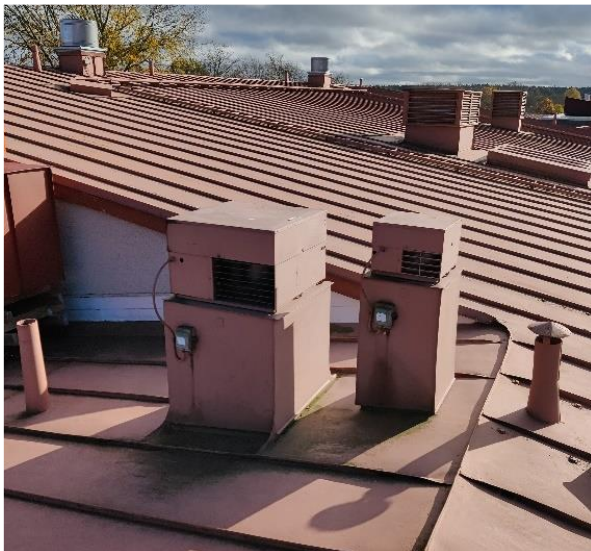
Kuva 129 Alkuperäisiä huippumureita vesikatolla.
