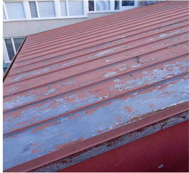
Kuva 93 Vesikatteen maalipinta on heikkokuntoinen.
