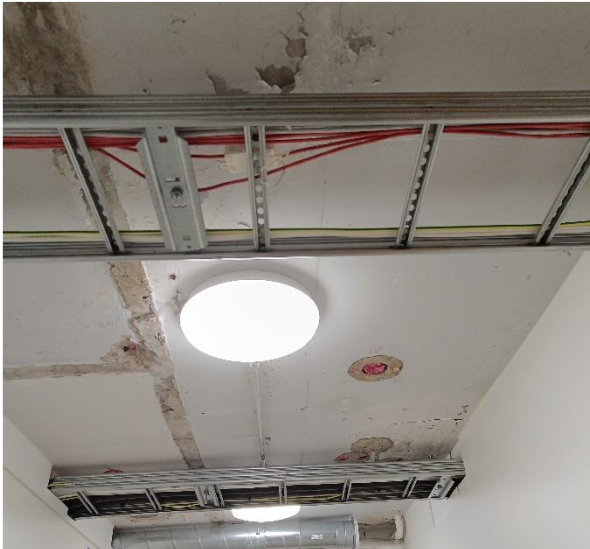
Kuva 55 Keittiön kohdalla oleva välipohjarakenne, jonka alapinnassa havaittiin kosteusjälkiä.
