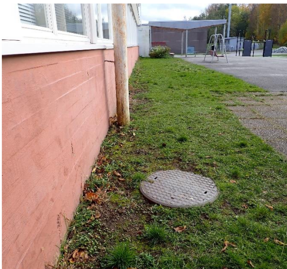
Kuva 9 Kuva rakennuksen eteläisivustalta. Maanpinnan kallistukset ovat tasaiset. Sadevesisyöksyssä ruostejätkiä.
