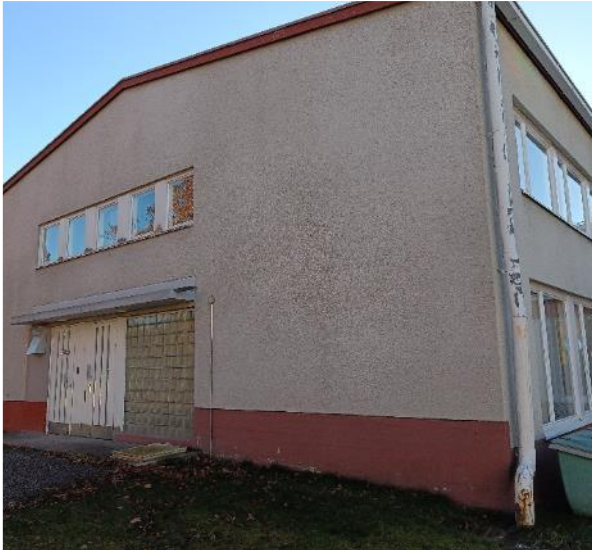
Kuva 3 Yleiskuva rakennuksen vierustalta ruokasalin kohdalla. Sadeveden syöksyputkessa on ruostejälkiä ja maalipinnan irtoilua.
