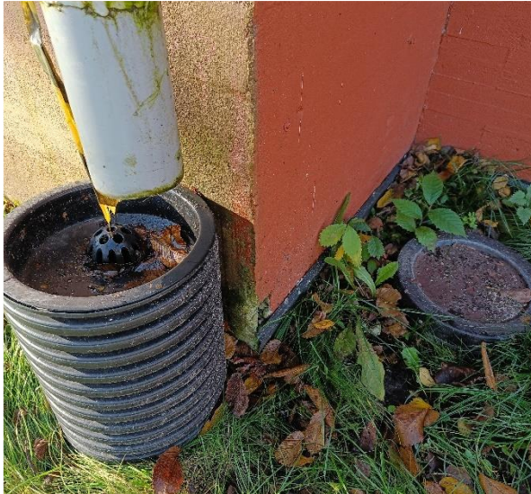
Kuva 7 Sadevesisyöksyä ei ole jatkettu sadevesikaukaloon asti. Sokkelissa havaittiin kosteusjälkiä ko. kohdassa.
