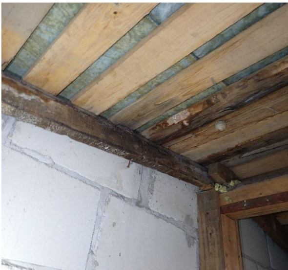
Kuva 106 B-osalla vesikaton rakenteissa havaittiin kosteusvauriojälkiä.
