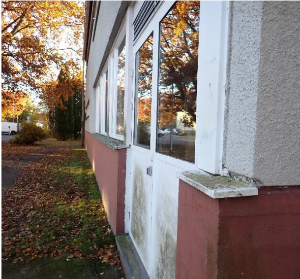
Kuva 76 Ikkunapellytyksien kallistuksissa on puutteita.
