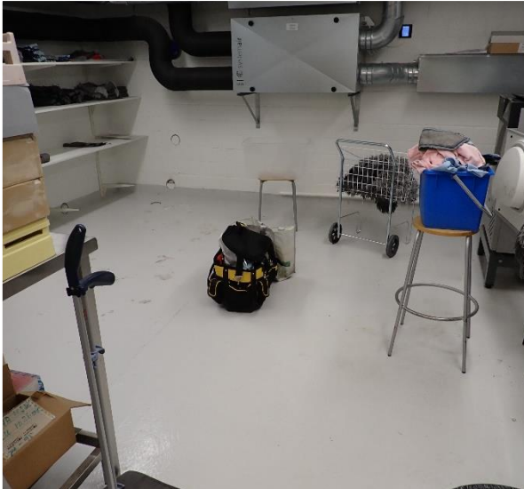
Kuva 47 Kellarin alapohjarakenteisiin on kohdistunut merkittävää kosteusrasitusta. Siivouskeskuksen alapohjarakenne on kostea / märkä. Tiloihin on noussut saatujen tietojen mukaan perusvesiä. Alapohjan pinnoitteet olivat monin paikoin irtoilleet kosteuden vaikutuksesta.
