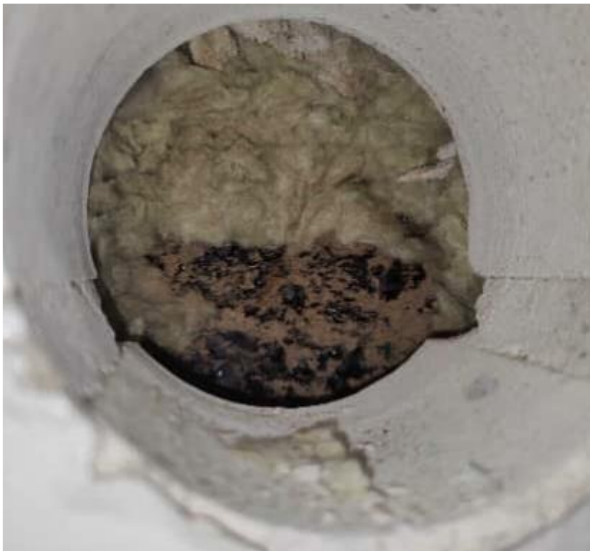
Kuva 32 Siivouskeskuksen puoleiset maanvastaaiset seinärakenteet ovat sisäpuolelta veden- ja lämmöneristettyjä ja tiiliverhoiltuja. Lämmöneristeissä on laajoja mikrobivaurioita ja eriste oli seinien alaosissa märkää.
