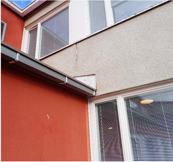
Kuva 65 Vauriojälki A-osan rappauksessa.
