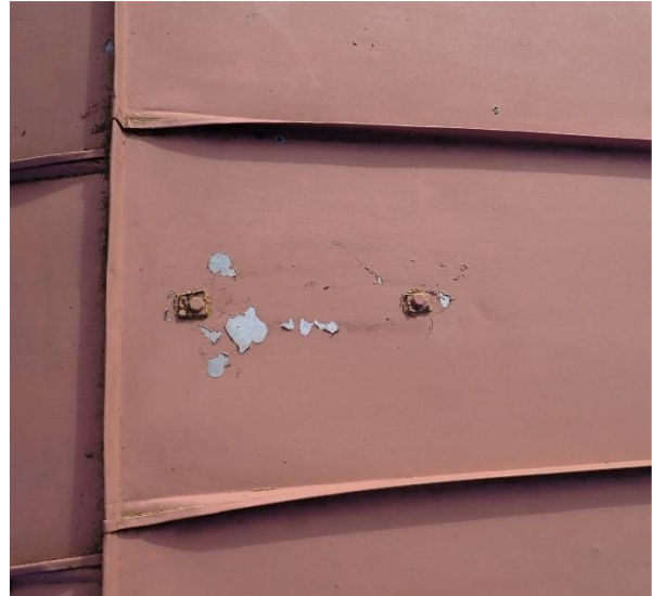
Kuva 85 Vesikatteessa on vanhoja kiinnikkeitä, joiden ei voida olettaa olevan tiiviitä.
