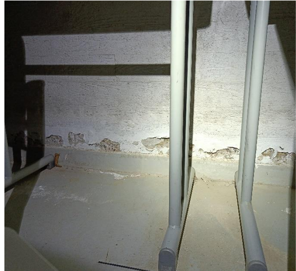
Kuva 31 Väestönsuojatiloissa todettiin kosteuden aiheuttamia vauriojälkiä maanvastaisten betoniseinien alaosissa. Vauriot painottuvat itäsivustalle.
