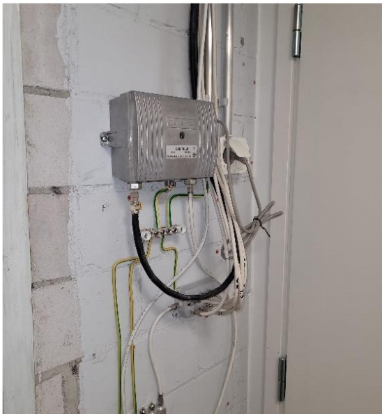
Kuva 155 Antennivahvistinlaitteita ja komponentteja.
