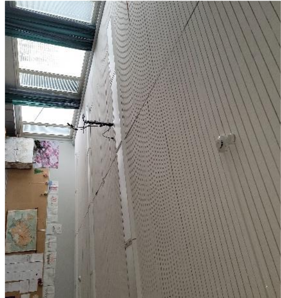
Kuva 146 Luokassa uusittua valaistusta.
