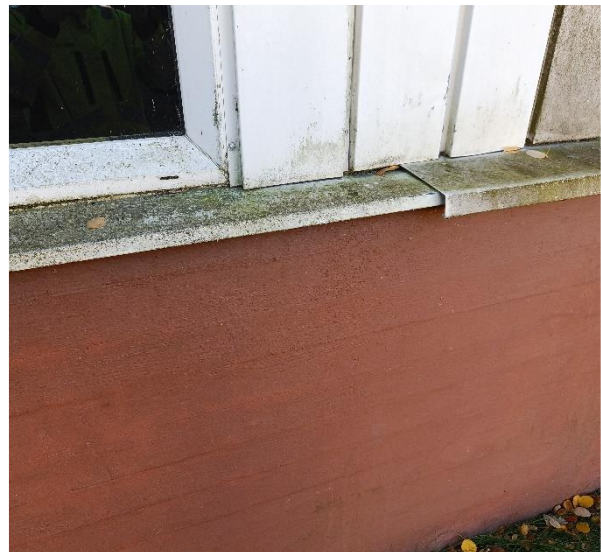
Kuva 75 Ikkunoiden pellitysten kallistukset ovat puutteellisia.
