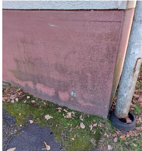
Kuva 25 Sokkeleissa havaittiin kosteuden aiheuttamia jälkiä varsinkin puutteellisten sadevedenohjausten kohdalla.
