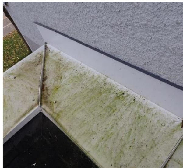
Kuva 91 Vesikaton pellitysten liittymä ulkoseinärakenteeseen on epätiivis keittiösiiven osuudella.
