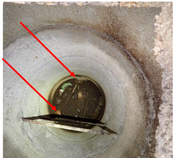
Kuva 13 Kaivon pohjalla ei havaittu vettä. Salaojaputket ovat alkuperäisiä tiiliäputkia. Putket olivat osittain tukossa.
