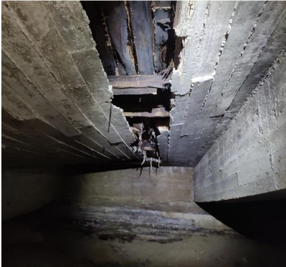
Kuva 43 Liikuntasalin romahtaneen alapohjarakenteen pintaan on muotitettu pohja uudelle valulle. Rakenteisiin jätetyt muottilauδοitukset ovat aistinvaraisesti vaurioituneita.
