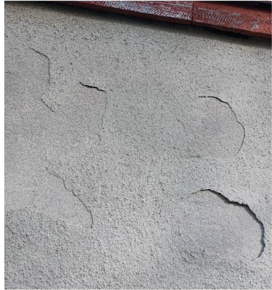
Kuva 66 Rappauspinnan irtoilua rakennuksen päädyssä C-osalla.
