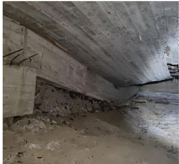
Kuva 42 Liikuntasalin keskiosalla havaittiin valuvaiheen muotituksen romahtamisesta johtunut painuma kantavissa rakenteissa. Havaintojen perusteella romahtaneiden rakenteiden päälle on valettu uudet kantavat rakenteet.
