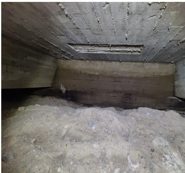
Kuva 16 Kosteutta liikuntasalin kohdalla perusmuurissa.
