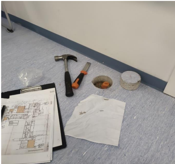
Kuva 57 Keittiön välipohjarakenteena on betonilaatta, jonka pintaan on asennettu askeläänieristeeksi lastusementtilevy ja pintalaatta.
