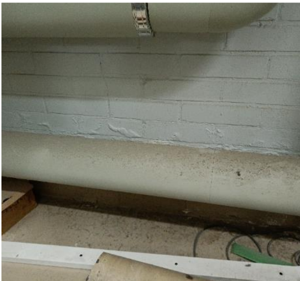
Kuva 28 Kosteusjälkiä maanvastaisen sisäpuolelta lämmöneristetyin ja tiiliverhoillun seinän alaosassa lämmönjakohuoneessa.
