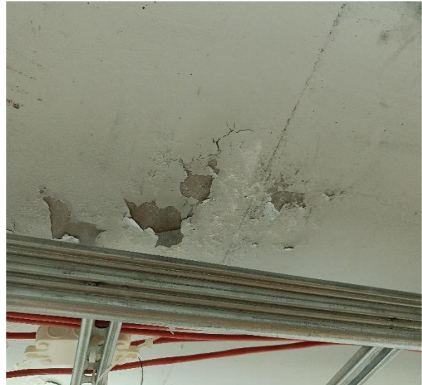
Kuva 56 Kosteusjäljet olivat tarkasteluhetkellä kuivia.
