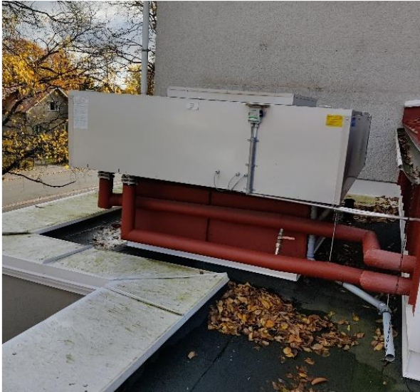
Kuva 131 Keittiön uusi lämmöntalteenotolla varustettu huippumuri.
