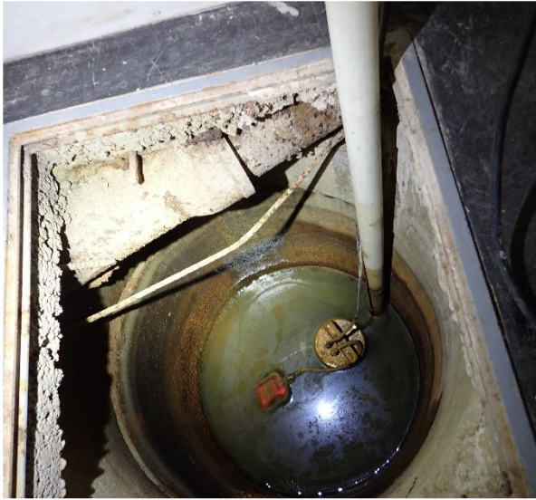
Kuva 14 Sähköpääkeskuksessa keittiön alla sijaitsee perusvesipumppaamo.
