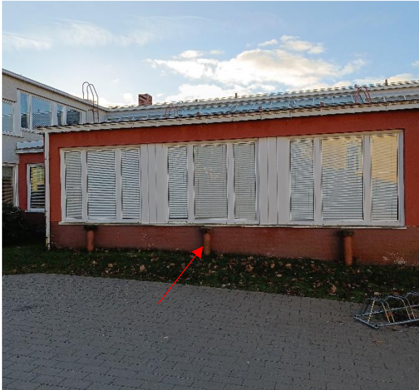
Kuva 51 Laajennusosan alapohjatilaa tuuletetaan tuuletusputkilla.
