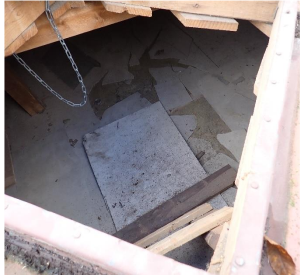
Kuva 101 A-osan yläpohjatila. Eristeiden pinnassa on sementtikuitulevyä, joka sisältää asbestia. Levytyksiä on rikkoutuneena useassa pisteessä yläpohjatilassa.
