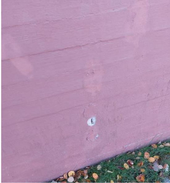
Kuva 18 Sokkelit ovat lautamuottipintaisia ja maalattuja. Sokkelin betonin pinnassa todettiin useita pintaterästen korroosion aiheuttamia vaurioita.
