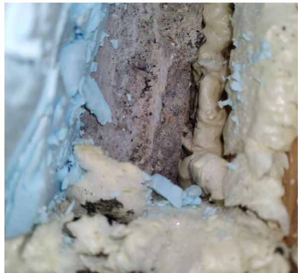
Kuva 82 Korjatun ikkunakoteloinnin sisäpuolinen ilmatiivyeys on heikolla tasolla. Betonipilarin ja ikkunan rajapinnan uretaanivaahdotus on epätiivis.
