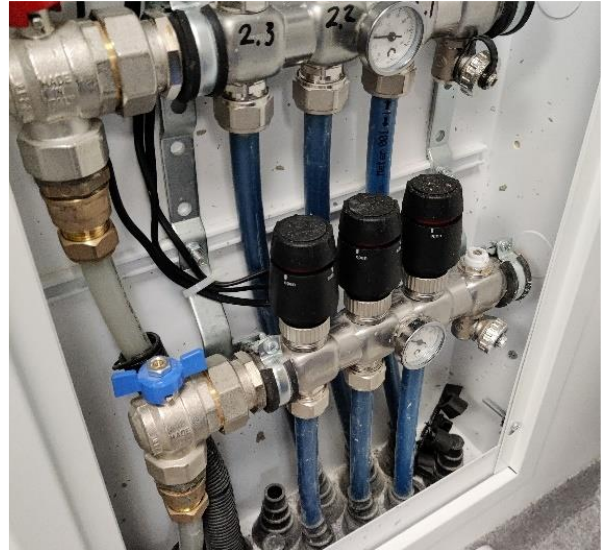
Kuva 118 Vuonna 2022 lisätty lattialämmitysjakotukki.
