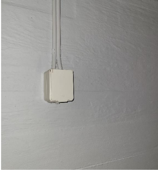
Kuva 139 Pistorasia ilmanvaihdon konehuoneessa.
