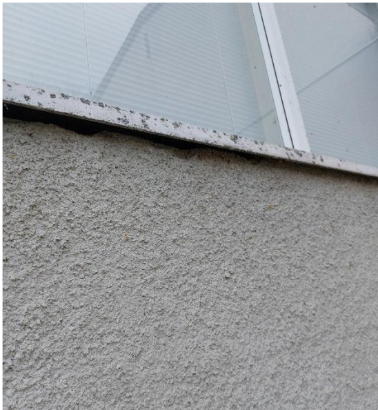
Kuva 78 Ikkunapenkin alaosan ja ulkoseinän välinen liitos on epätiivis. Viistosadetta voi kulkeutua rakenteeseen.
