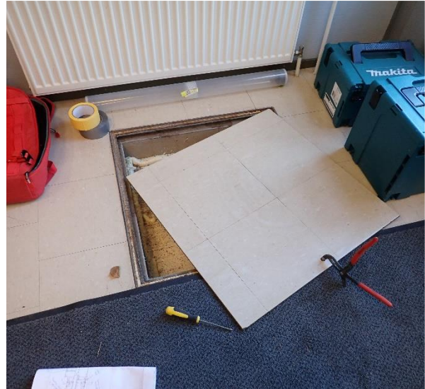
Kuva 52 Kuva C-osan laajennuksen alapohjan tarkastusluukusta. Alapohjatilassa havaittiin kosteutta.
