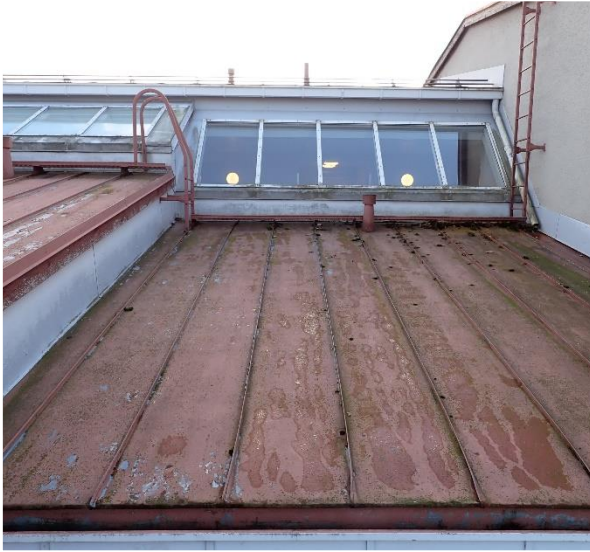
Kuva 92 B-osan vesikatteen kunto on heikko.
