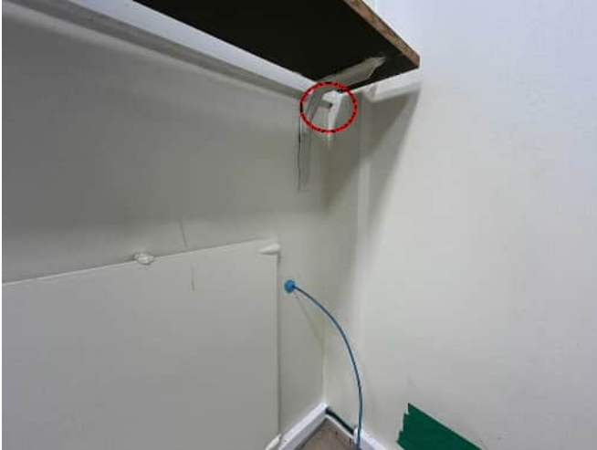
Kuva 3 Vuoto havaittu ikkunan alapuolella.
