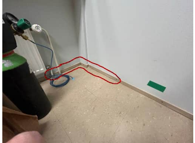
Kuva 6 Vuotoa lattian ja seinän liitoksesta.
