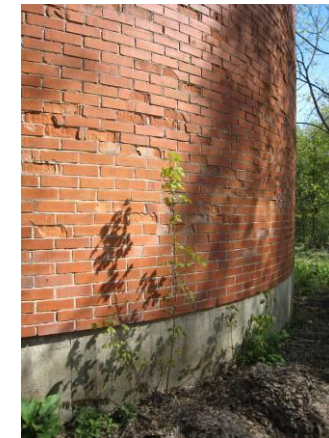
Kuvat 149 ja 150 yllä: Pumppaamorakennus 88 ja sen takana ammusvarasto. Puhdistamon julkisivutiilit ovat osittain rapautuneita.
