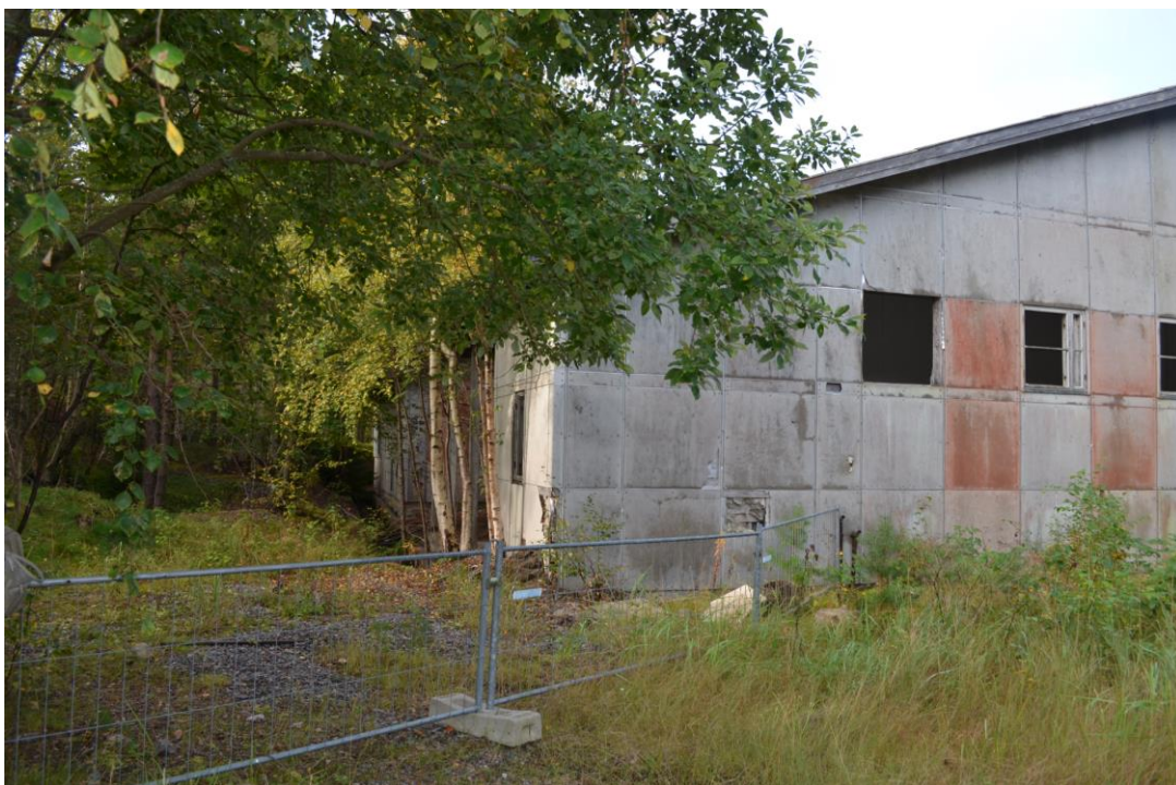
Bild 14. Renovering av byggnaderna är huvudsakligen inte möjligt. (Bild FCG 2014)
